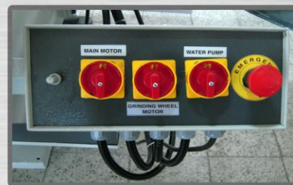
Панель управления с выключателями
